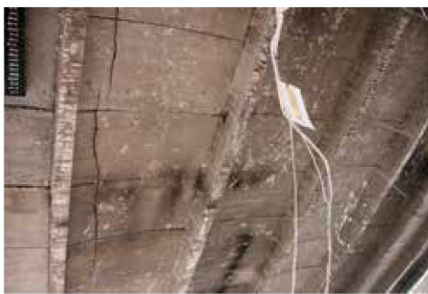
Były przekroczone jego nośności, widać zarysowania łupin i bardzo dużo spękań na płytach stropowych.
